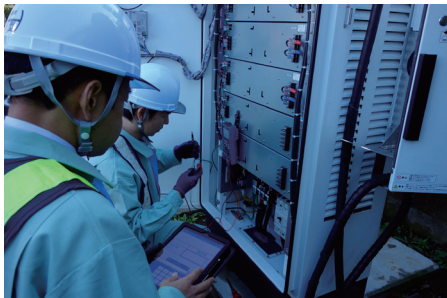
急速充電器の急増が課題となっており、i-Reporterの活用により点検業務の効率化が期待される
